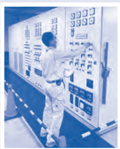
6,600ボルトの 受変電設備日常点検風景
