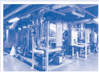
冷温水発生機で ビル全館の空調管理を行っています
