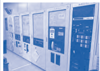
防災盤でビル全体の安全管理を行っています
